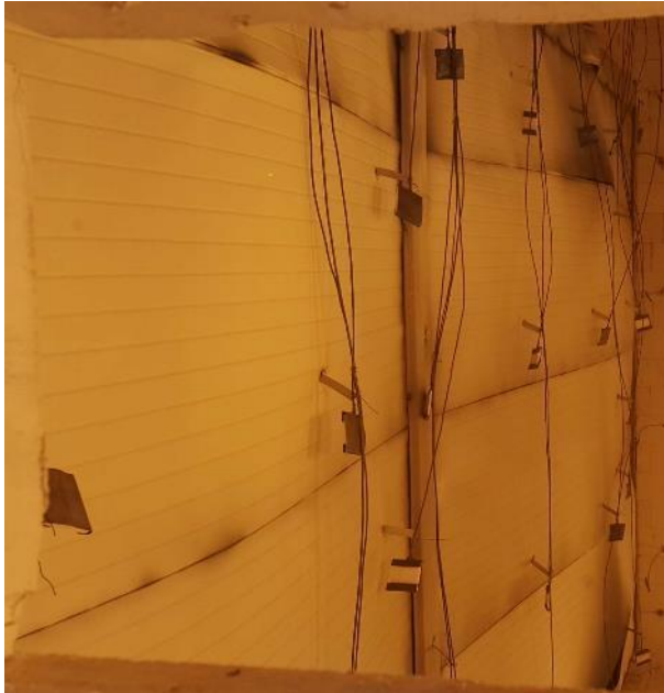
Abb. 8.5: Deckschalen FS abgelöst (6')
