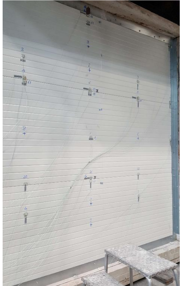
Abb. 10.6: Wand mit Wölbung (21')
