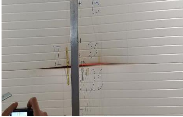
Abb. 9.11: Fuge II stark geweitet (24')
