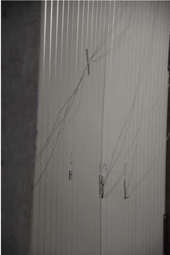
Abb. 13.7: Fuge bei Mst. 16/17 wölbt sich Richtung Brandraum (33')
