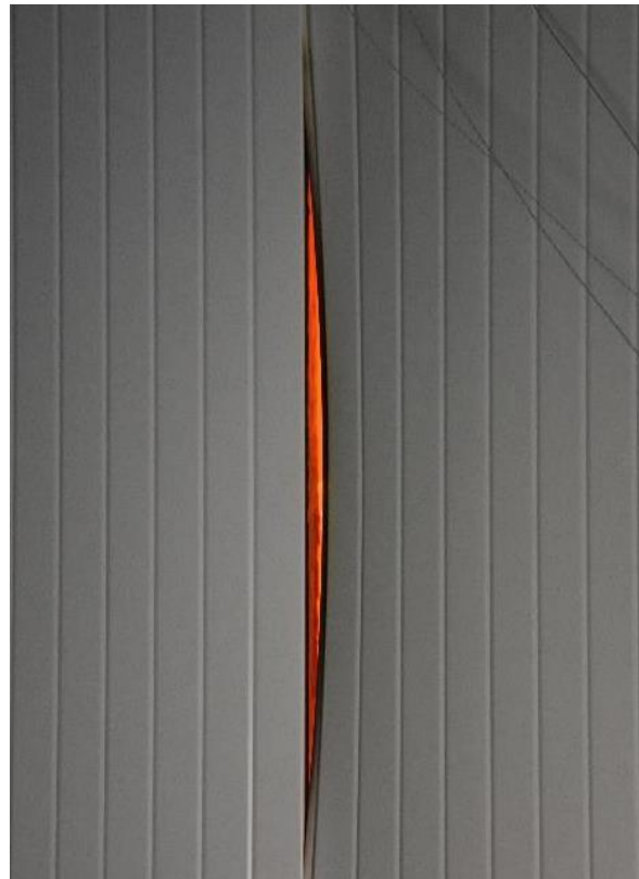
Abb. 13.10: Fugenöffnung im Bereich der Mst. 6/7 und 10/11 (37')
