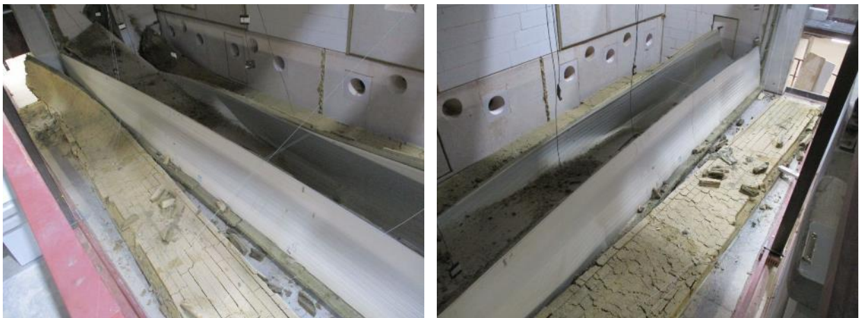
Abb. 5.26 und 5.27: Abfallen der Sandwichelemente nach Abkühlung
