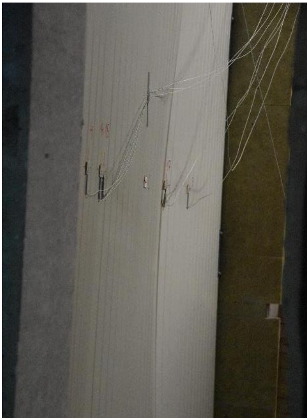
Abb. 12.7: Stoßfuge im Bereich Mst. 16/17 in den Brandraum gewölbt (68')
