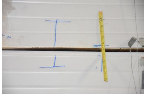
Abb. 9.12: Fuge I stark geweitet (25')
