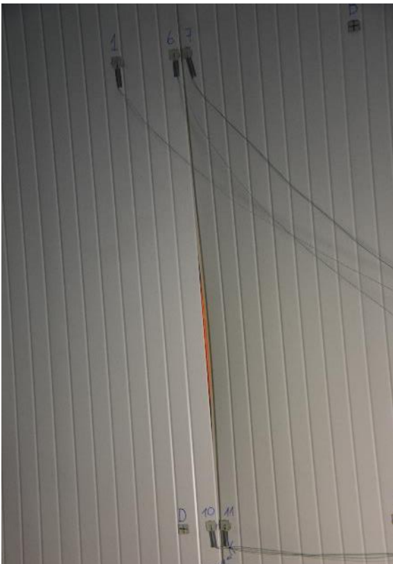
Abb. 13.9: Fuge zwischen Mst. 6/7 und 10/11 wölbt sich Ri. Brandraum und öffnet sich (36')
