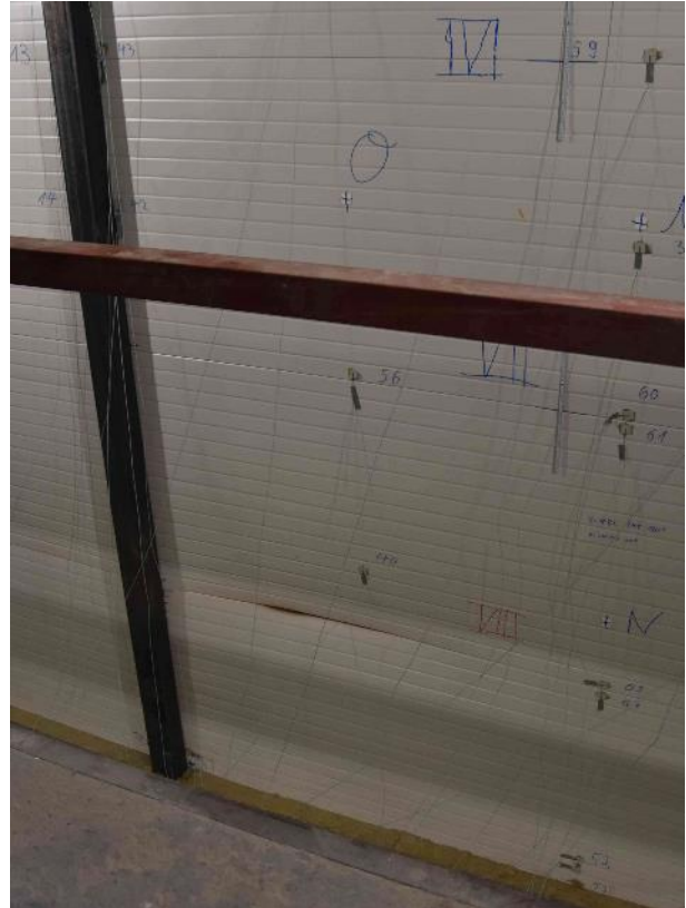
Abb. 8.19: Einfallen Fuge Mst 40 (100')
