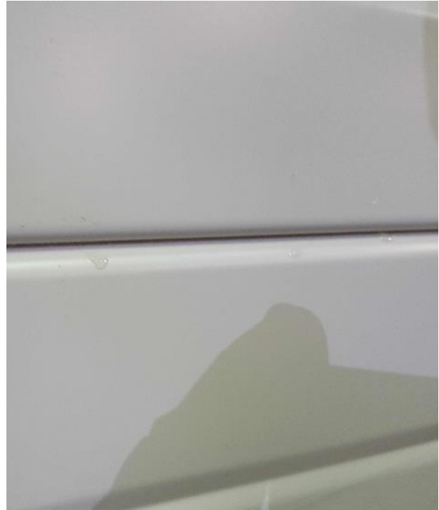
Abb. 7.12: Kondenswasser an Fuge (70')
