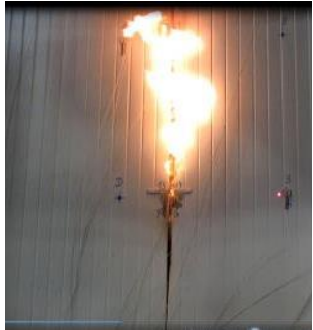
Abb. 14.6: Flammenaustritt im Bereich der Fuge zwischen den Mst. 8/9 und Mst. 13/14 (29')
