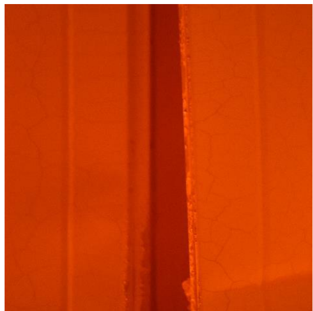
Abb. 13.6: Beschichtung der Paneele weist netzartige Risse auf (20')
