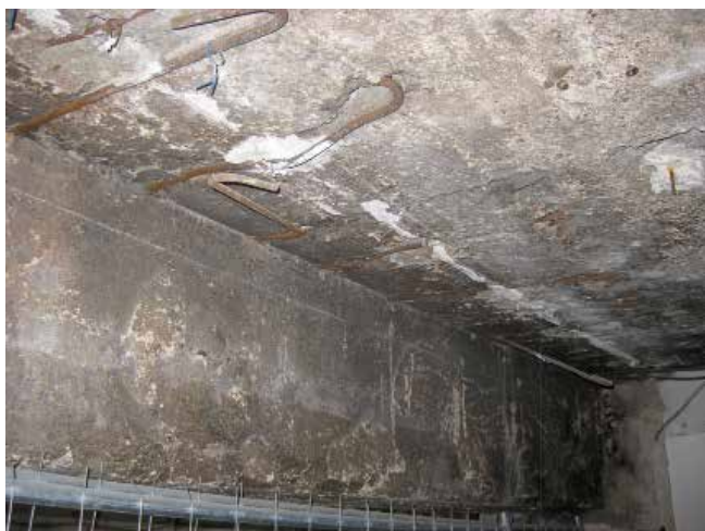
Abb. 6: Ausführungsmängel: freiliegende Rückverankerung der glatten Bewehrung
