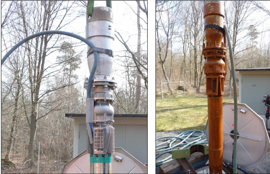
Abbildung 2: Der Austausch von alten Trinkwassergewinnungspumpen ist eine hochwirksame Energieeffizienzmaßnahme [Quelle: WILO SE]
