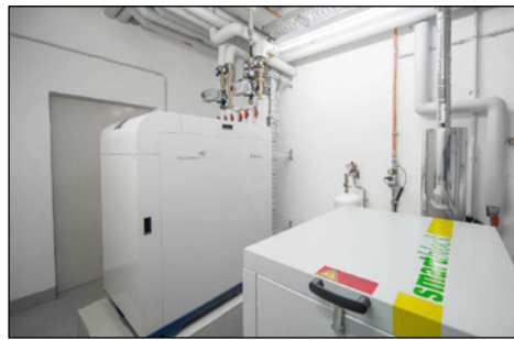
Abbildung 3: Technikraum [Foto: J. Groß]
