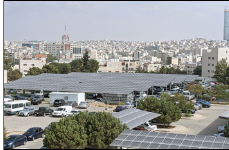
Abbildung 4: PV-Anlage als Parkplatzbedachung [GFA Consulting Group GmbH]
