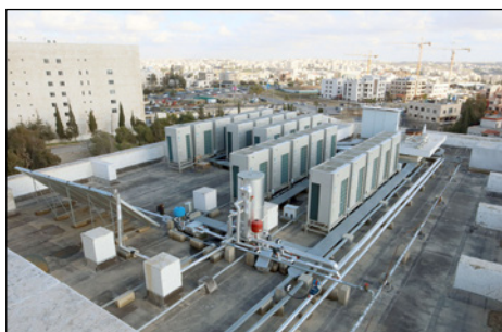
Abbildung 5: VRF-Klimaanlage auf dem Dach eines Ministeriums [GFA Consulting Group GmbH]
