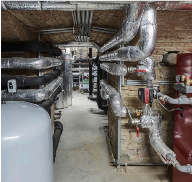
Abb. 02: Hautechnikzentrale im Bestandskeller [Foto: Kurt Hoerbst]
