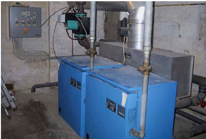
Abb. 02: Bestehende Heizungsanlage mit Konstanttemperaturkessel
