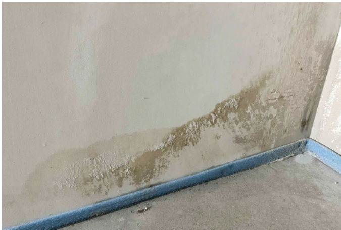
Abb. 07: Kellerwand mit Wasserrändern und Salzausblühungen
