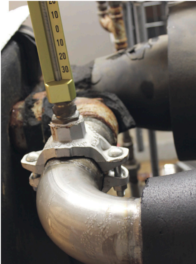
Abb. 03: Bei einer vertikalen Wasser-Wasser-Geothermianlage ohne durchgehende Wärmedämmung des »kalten« Wasserkreislaufs (in dem Grundwasser mit einer Temperatur von ca. 13 °C zirkuliert) bildet sich vor der Wärmepumpe Kondenswasser, was zu Korrosionsproblemen führt. [Foto: AQC]
