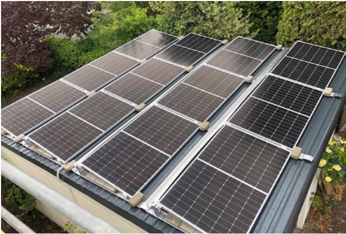
Abb. 03: PV-Anlage auf dem Garagendach
