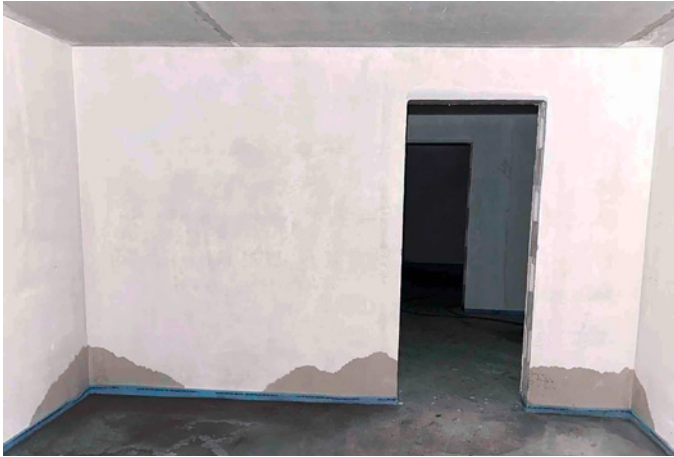
Abb. 02: Durchfeuchtung am Fußpunkt einer Kellerinnenwand
