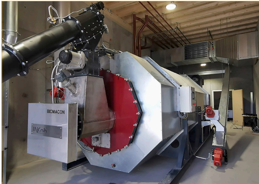
Abb. 01: Biomacon Pyrolyseanlage [Foto: Zindel United]
