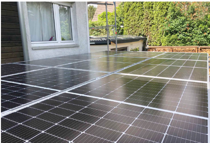
Abb. 02: PV-Anlage auf einem Nebendach
