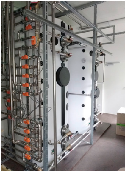
Abb. 01: Nieder- und Hochtemperaturspeicher [Foto: Ulrich Lüdersen]
