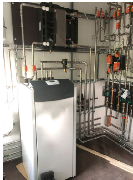
Abb. 02: Wärmepumpe im Energiecontainer [Foto: Ulrich Lüdersen]
