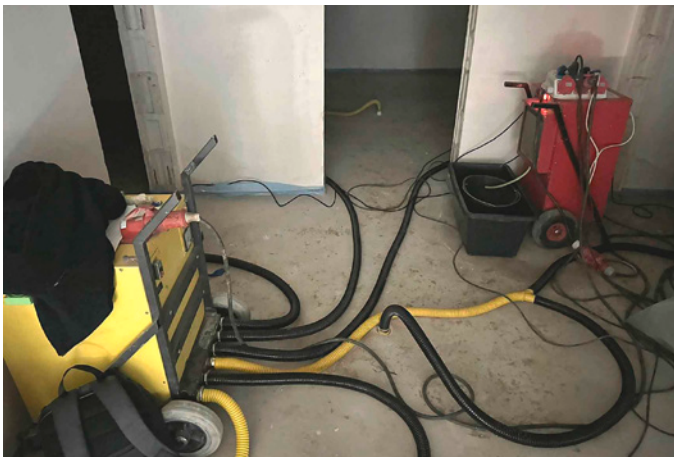
Abb. 05: Trocknungsanlage in einem Kellerraum
