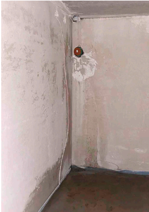
Abb. 01: Kelleraußenwand mit Wasserablaufspuren unterhalb einer Wanddurchdringung
