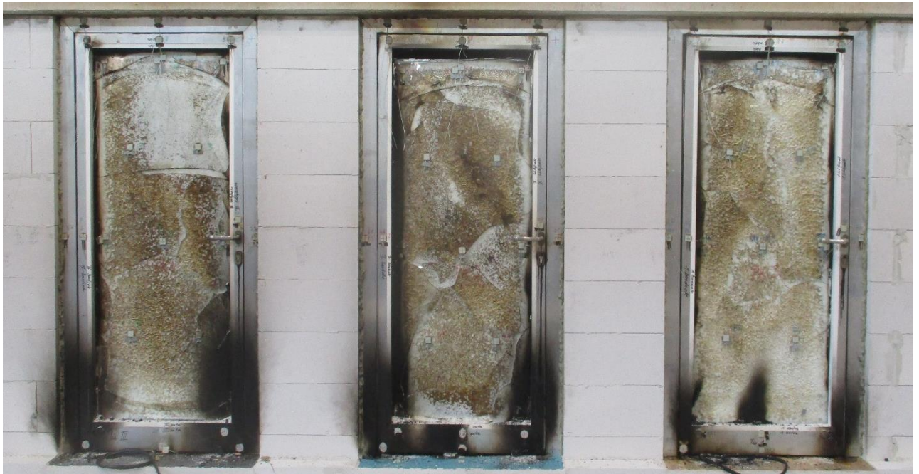
Abbildung 42: V 2 - Prüfelemente nach dem Brandversuch (unbeflammte Seite)
