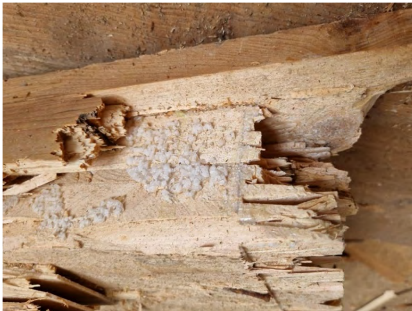
Abbildung 2.4: Leimfuge zwischen Unterseite Stegplatte und Blendbrett mit zu dicker, versprödeter Leimfuge
