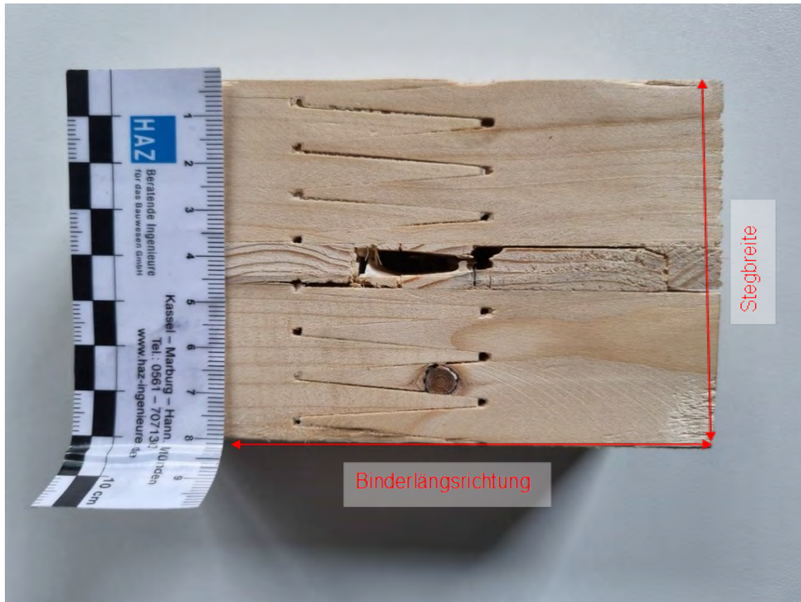
Abbildung 2.7: Herausgeschnittene Keilzinkenverbindung mit mangelhaften Fugen
