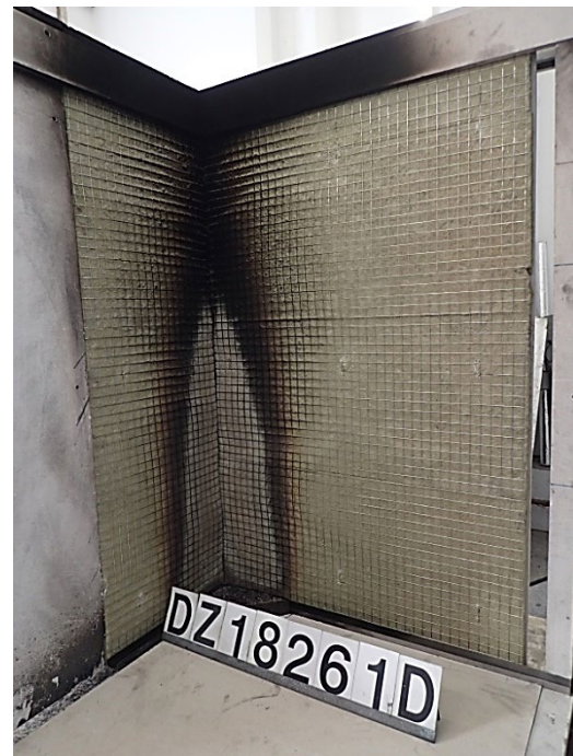
Foto 16: Probekörper MW-L-O, Ansicht nach der Prüfung.
