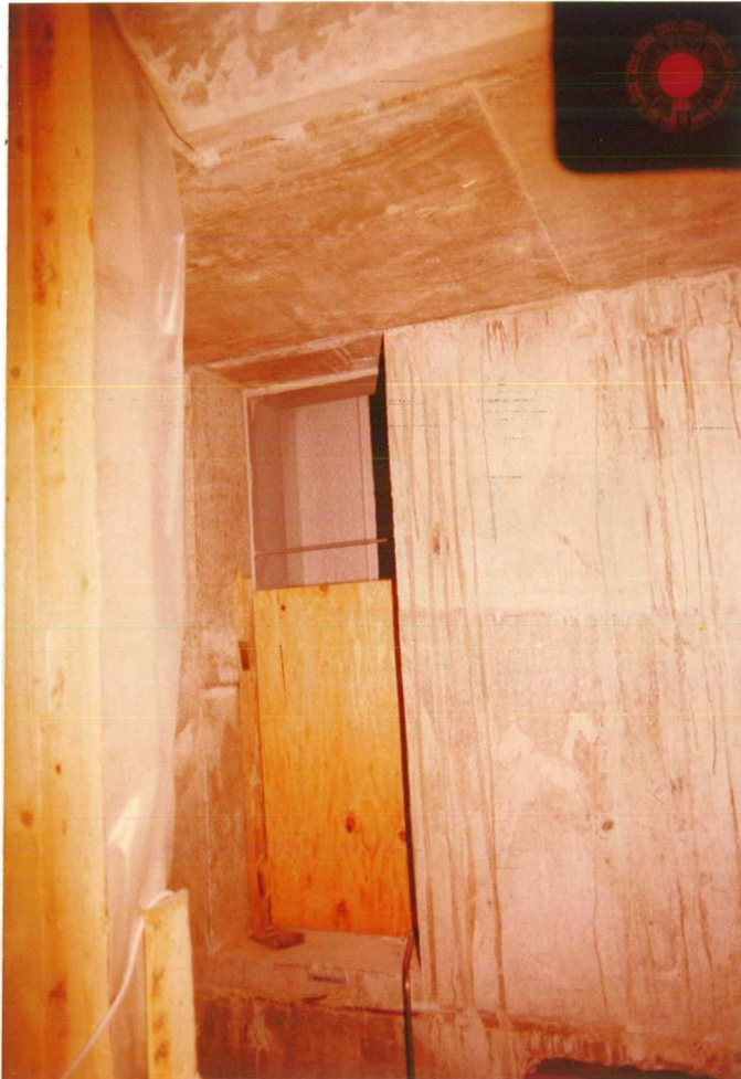
Bild 16 Luftaustrittsöffnung im Treppenraum 2 Der freie Austrittsquerschnitt wurde entsprechend dem Stömungswiderstand des Austrittsgitters verkleinert
