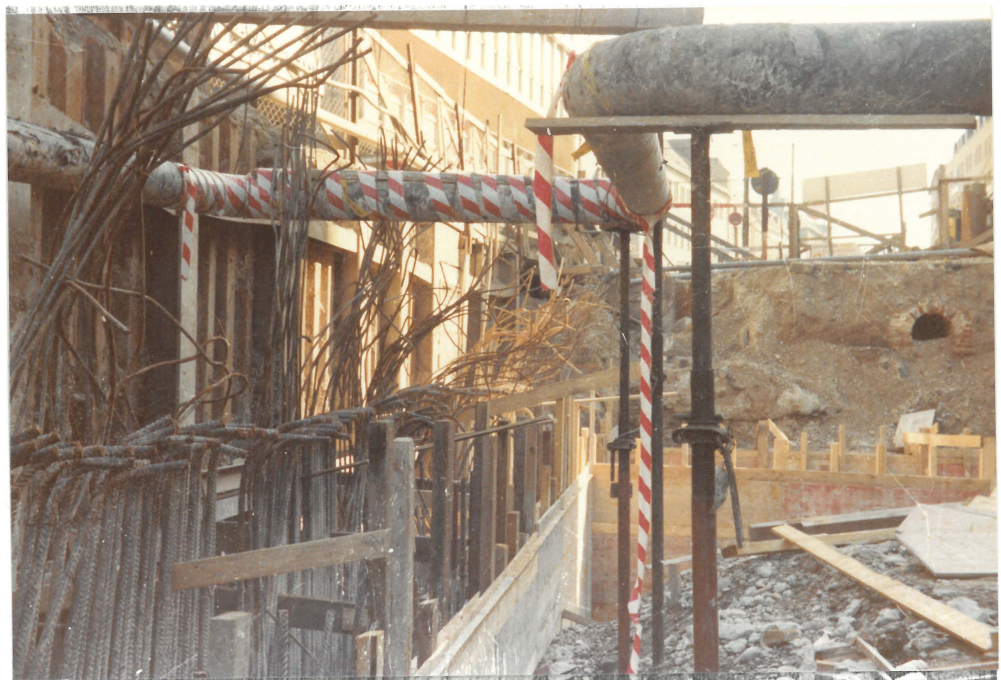
Bild 1: Schlitzwandbaustelle, stark verbogene Anschlußbewehrung
