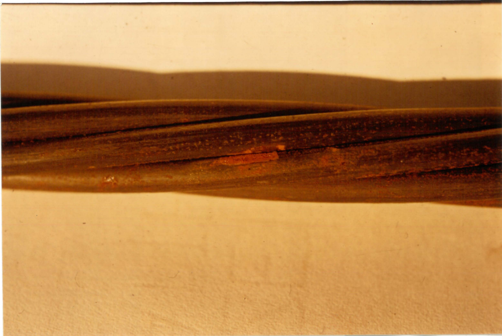
Abb. 21 Korrosion im Zwickelbereich von Litzen
