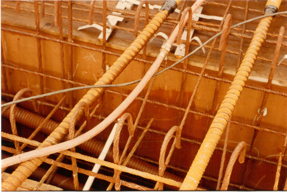
Abb. 31 Auftropfen von Wasser aus einem schadhaften Schlauch auf Spannglieder
