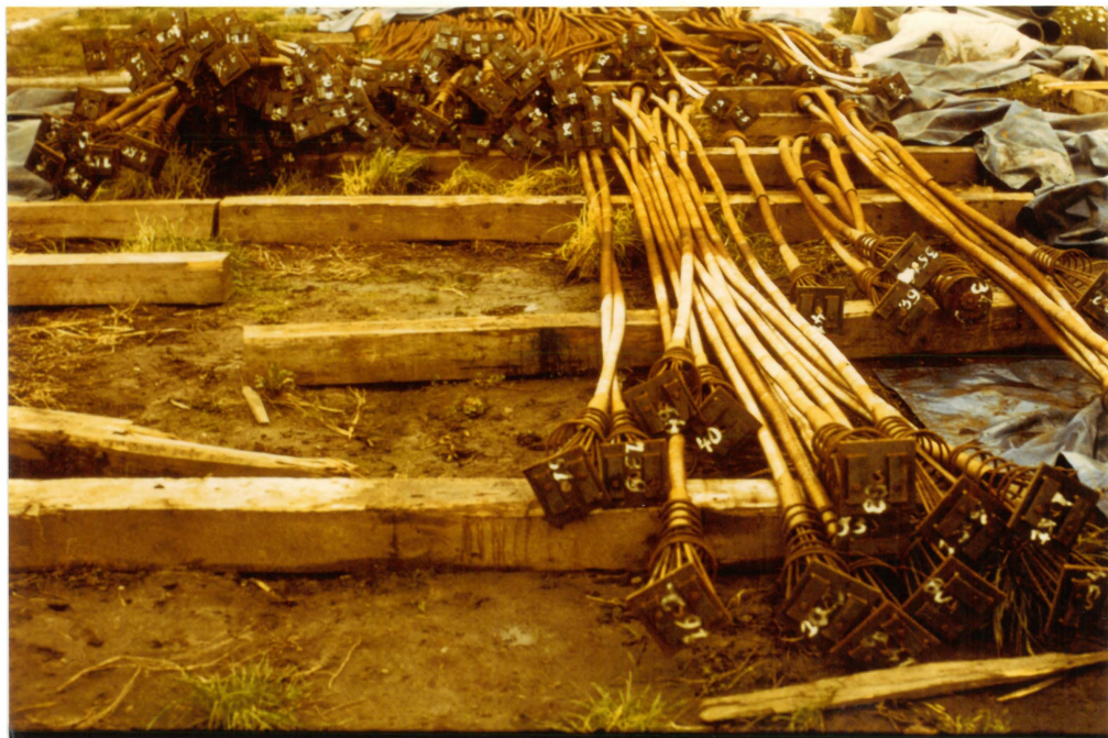
Abb. 16 Ungünstige Lagerung von Spann- gliedern (SUSPA) auf der Baustelle
