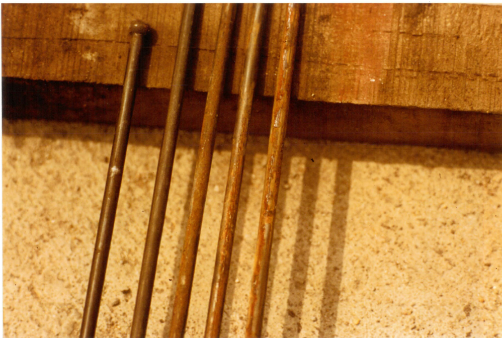
Abb. 52 Korrosionszustand verschiedener Spanndrähte
