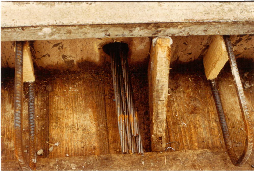
Abb. 55 Überstehende Enden am Spannanker
