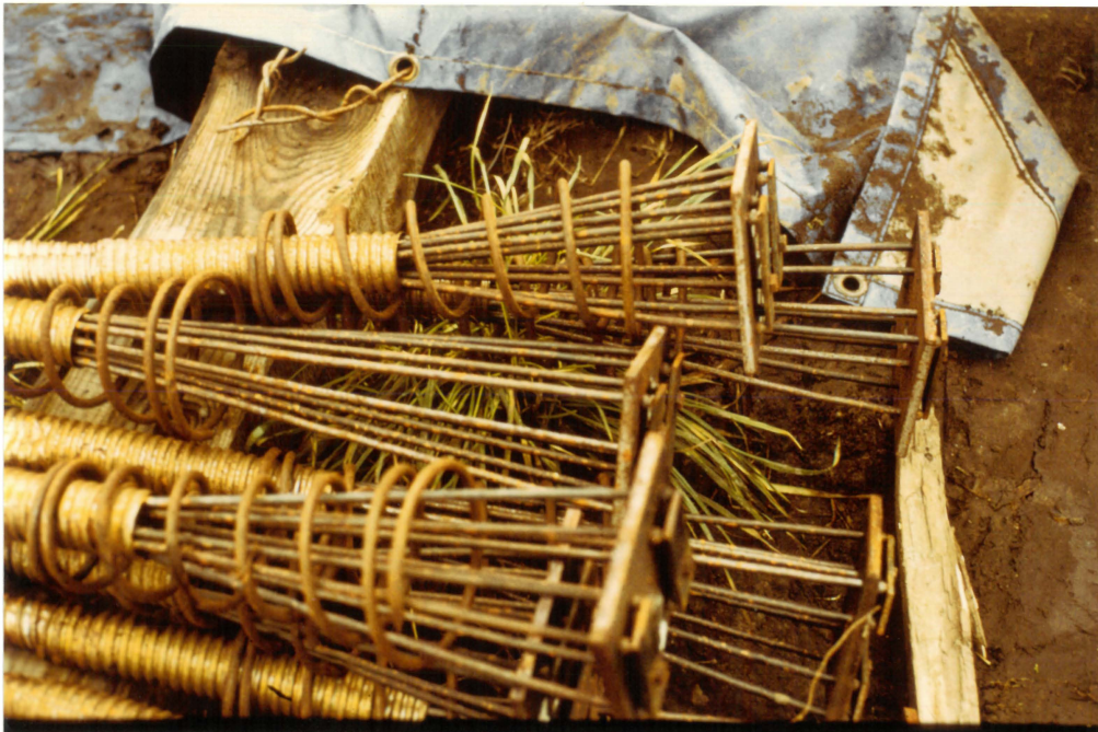
Abb. 18 Punktförmiger Korrosionsangriff durch Kondenswasser an Spanngliedenden
