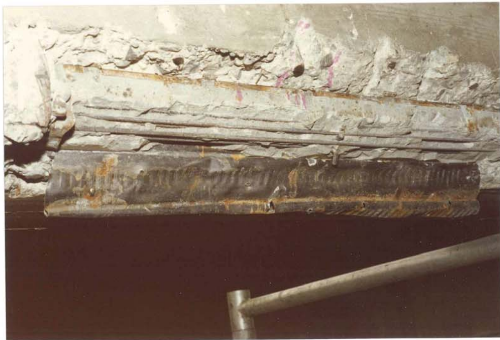
b) Drähte des Spanngliedes Nr. 5 (Feld 9, Mitte, Oberstromseite)
