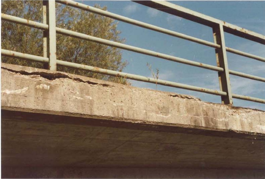
Bild 8. Oberstromseitige Brückenkappe in Feld 1 mit Rissen und schalenförmigen Betonabhebungen
