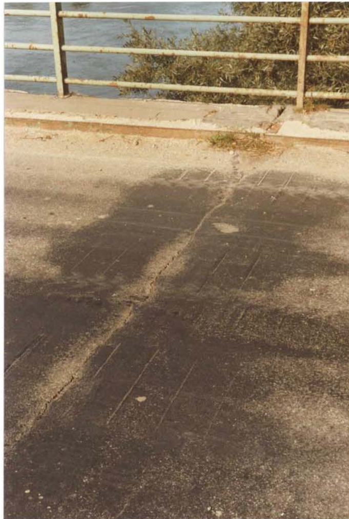
Bild 7. Riß im Asphaltbelag über der Stoßstelle der Felder 7/8
