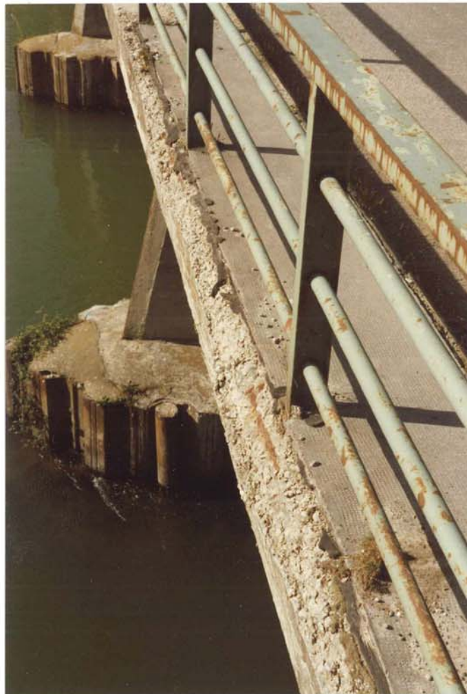
Bild 9. Oberstromseitige Brückenkappe in Feld 4 mit Kantenabwitterung und freiliegender, korrodierter Kantenbewehrung
