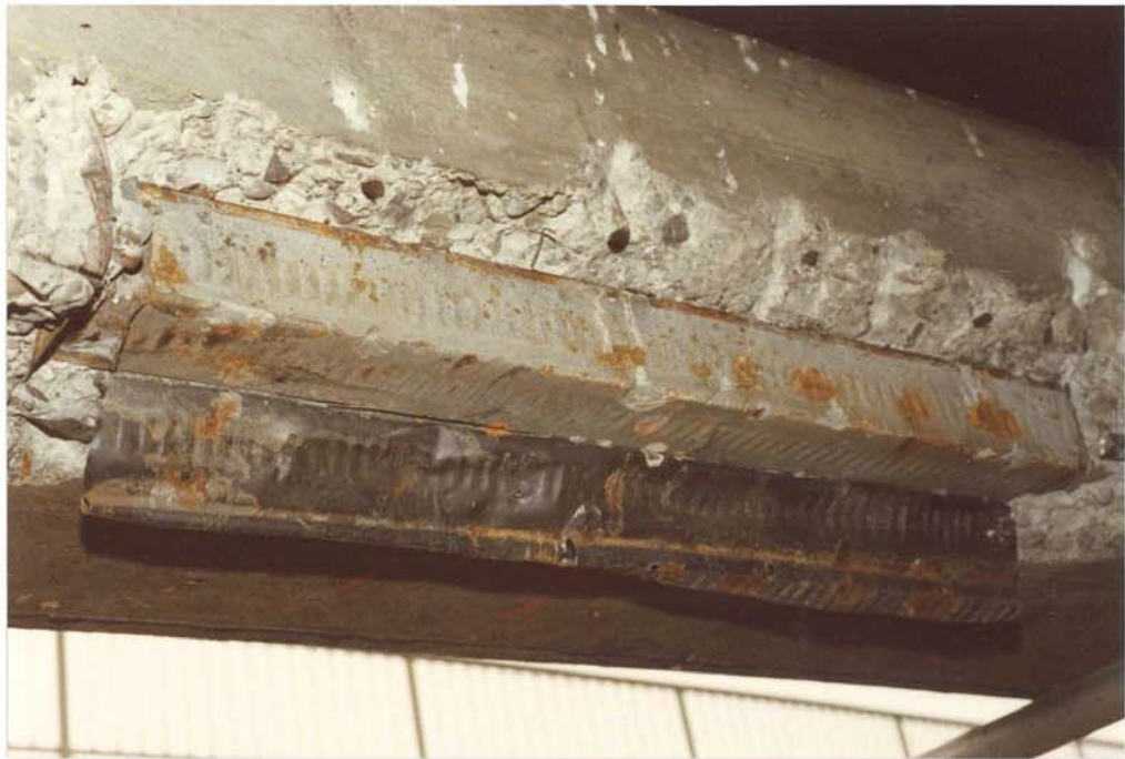
a) Verpreßzustand des Spanngliedkastens Nr. 5 (Feld 9, Mitte, Oberstromseite)
