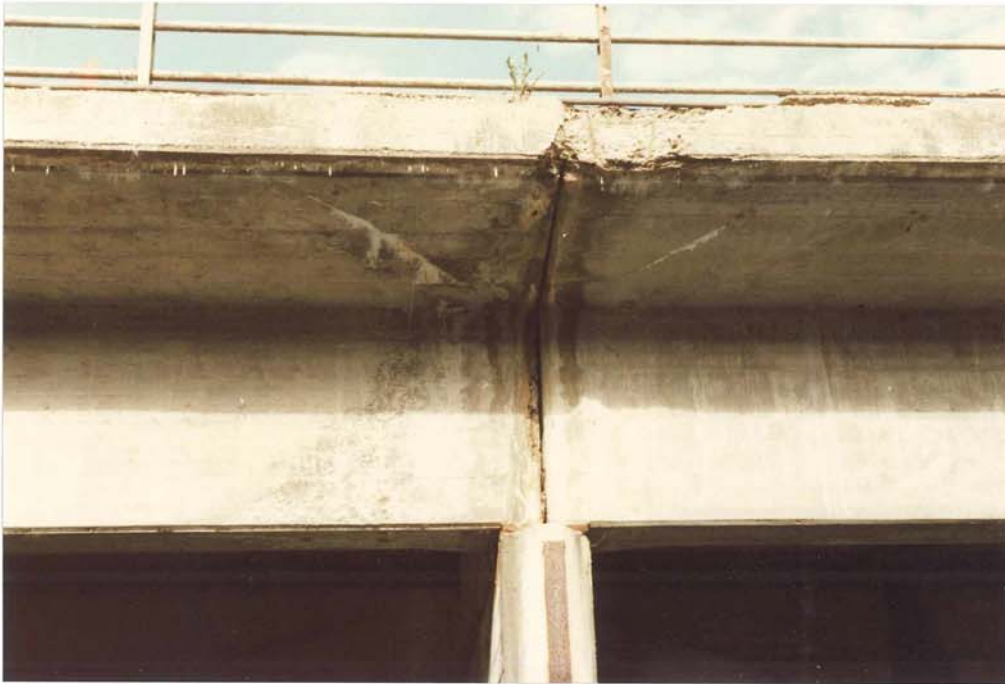
Bild 6. Spuren von Wasserdurchtritt im Bereich der Stoßstelle zweier Fertigteile (Übergang Feld 10/11)
