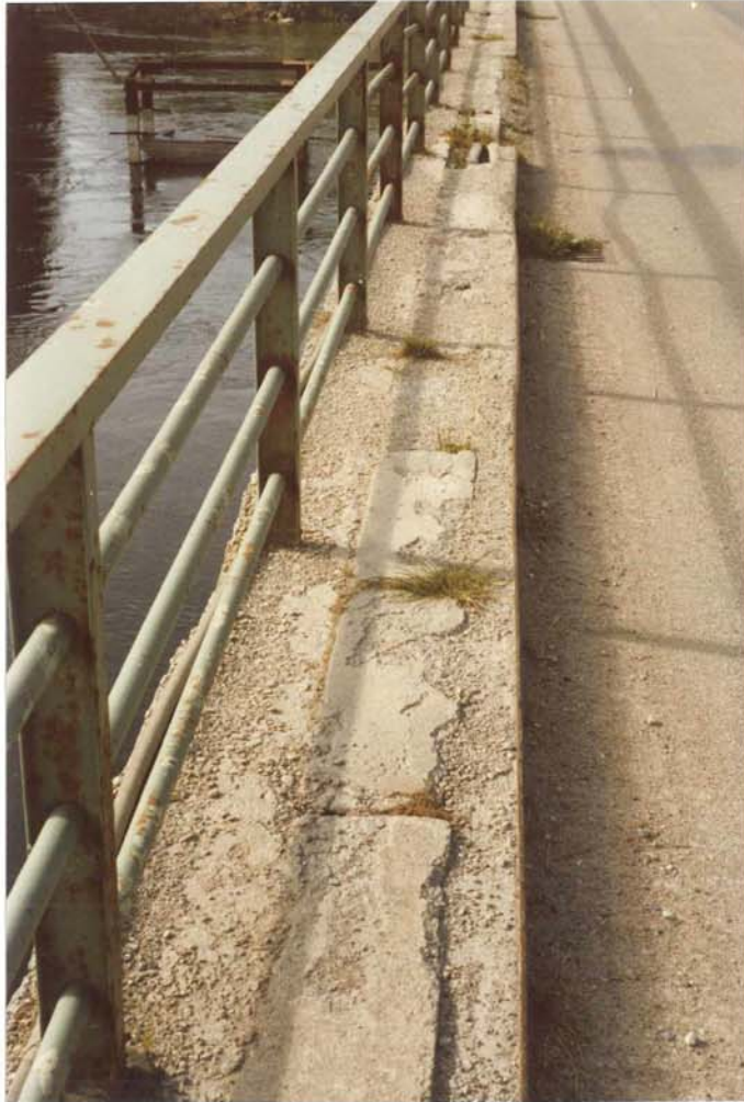
Bild 10. Zustand der Oberseite der Brückenkappen mit geschädigten bzw. gebrochenen Kabeldurchführungsfertigteilen (Felder 6 und 7)
