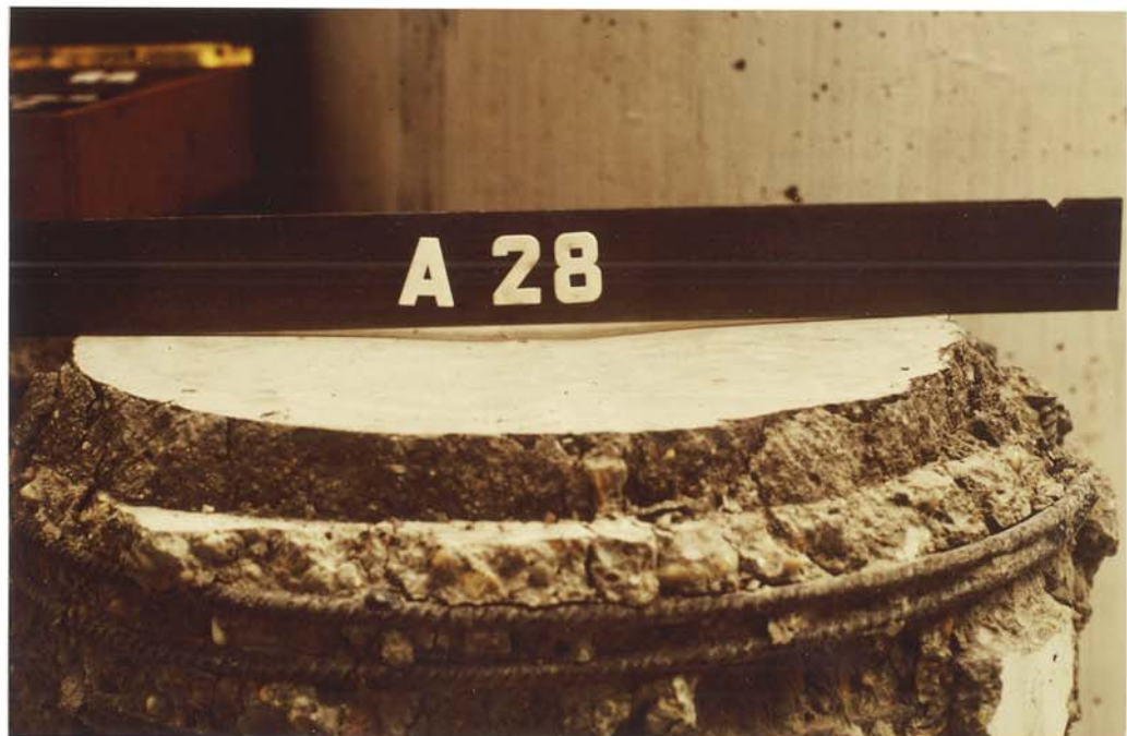
Bilder 19 und 20 : Einstanzen der Lagerplatte bei steifer und bleibende Setzungsmulde bei weicher Lasteinleitung in einen Stahlbetonzylinder Ø 480 mm nach Versuchsende
