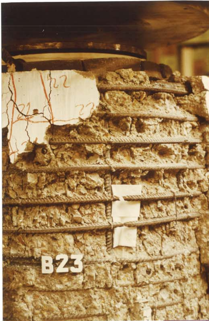
Bild 17 : Übliche Versagens- ursache: Wendelbruch
