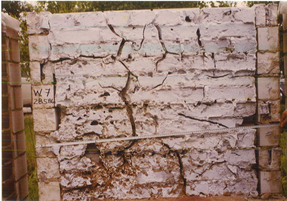
Bild 9: Ansicht des UF-Schaumes "A" in Wand 7 nach Entfernen der Vor- mauerschale
