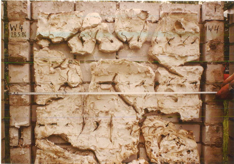
Bild 7: Ansicht des UF-Schaumes "E" in Wand 4 nach Entfernen der Vormauerschale
