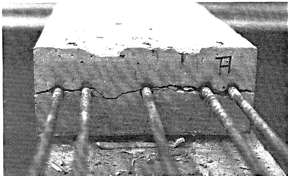
Bild 18: Balkenversuch mit profiliertem Spanndraht \varnothing 7,5 mm Sprengrisse an der Endfläche A des Versuchskörpers nach Ablassen der Vorspannkraft (75% der Stahlzugfestigkeit)
