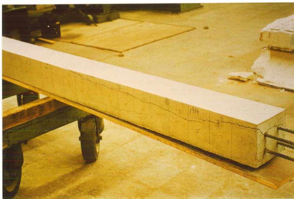
Balkenende ohne Umschnürungsbewehrung
