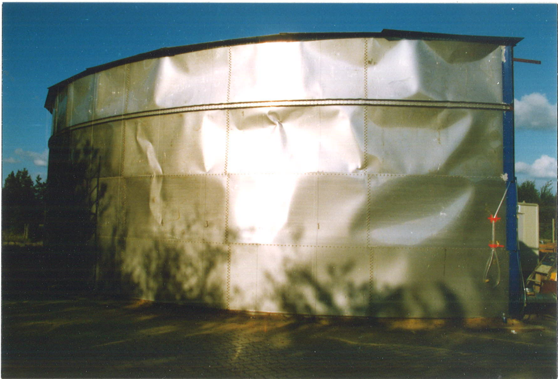
Bild 7.13: Beulbild bei einem Unterdruck von 150 mm WS (Behälter mit 3 Ringversteifungen)
