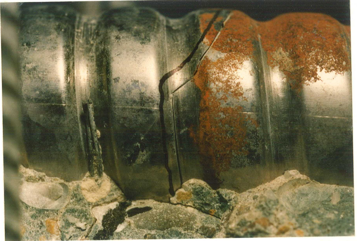
Korrosionsprodukte an der Hüllrohroberfläche
