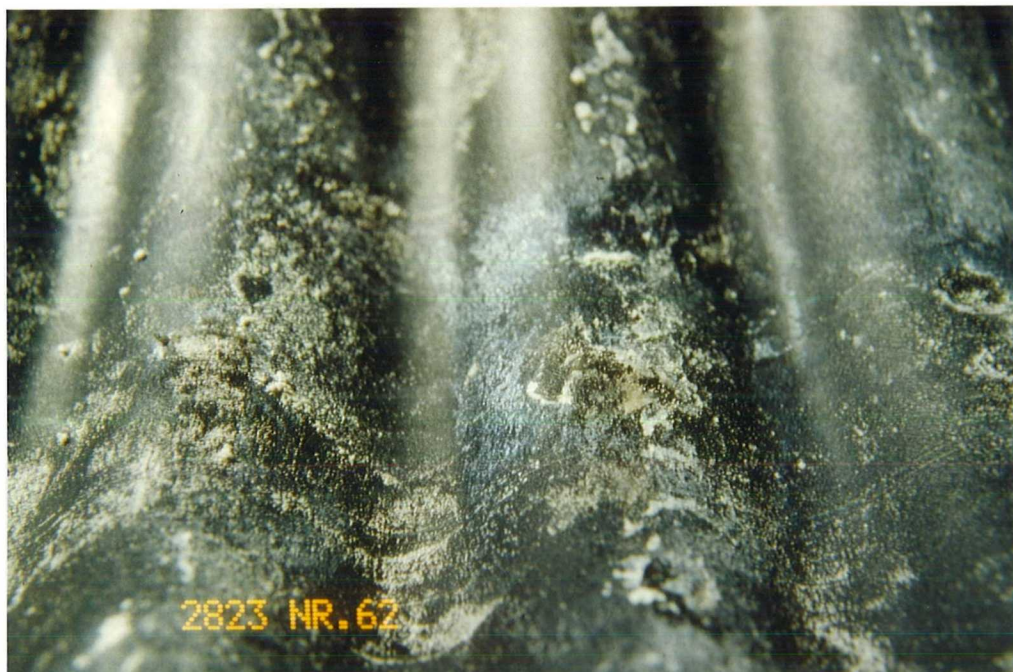
Bild 25: Detail der Reibstelle am Hüllrohr. Eindrückung 0,3 mm tief.
