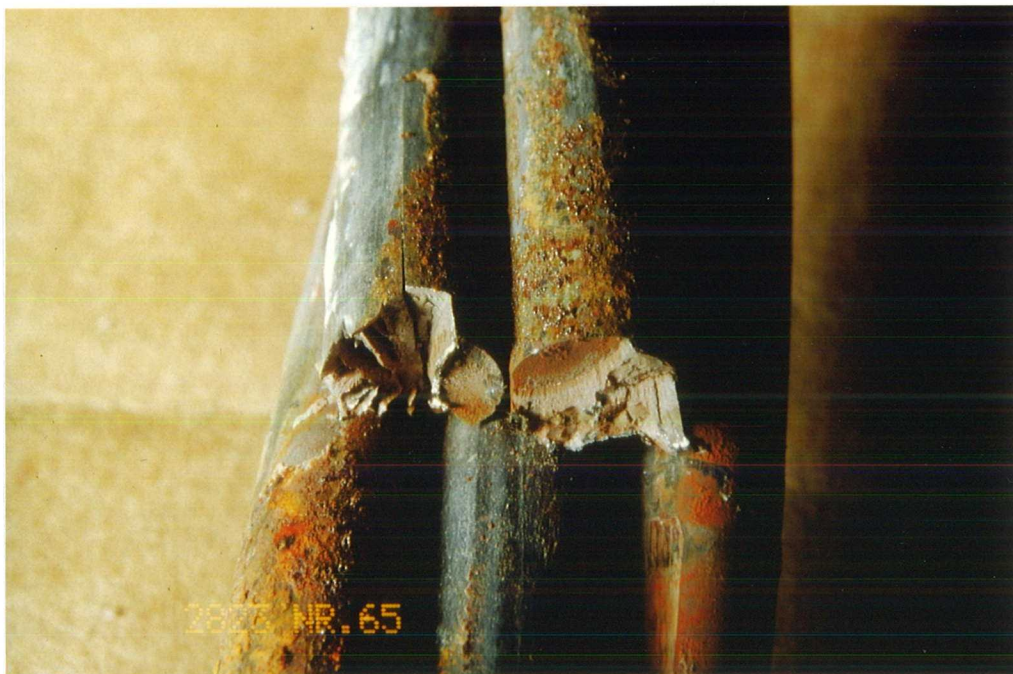
Bild 31: Detail des Bruchs einer Spanndrahtlitze Probe PP-M-L 4: Reibweg 0,20 mm Anpreßkraft 120 N/mm (!)
