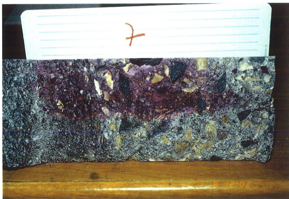
Bild 23: Bohrkern Nr. 7 Prüfung der Karbonatisierungstiefe durch streifenartiges Aufsprühen von Phenolphthalein auf die aufgespaltene Bruchfläche
