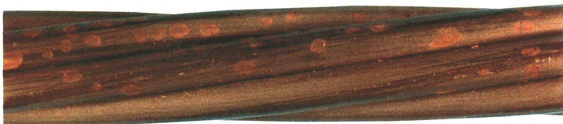
b) Oberfläche befreit von losen Korrosionsprodukten
