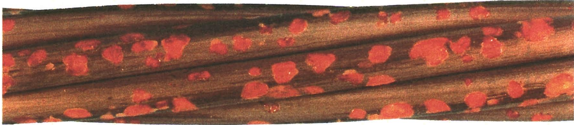
a) Oberfläche von losen Korrosionsprodukten nicht befreit
